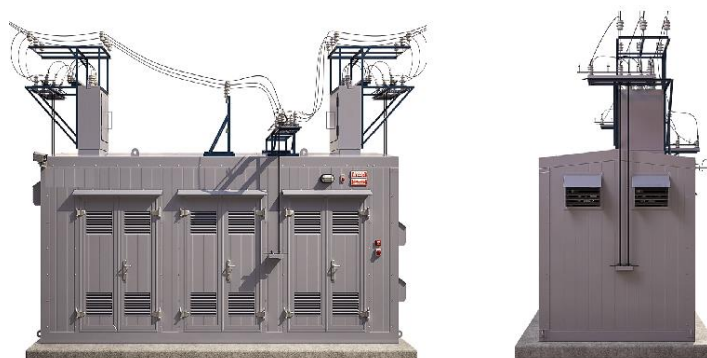
Рисунок 1 – Пункт автоматического регулирования напряжения (ПАРН)
